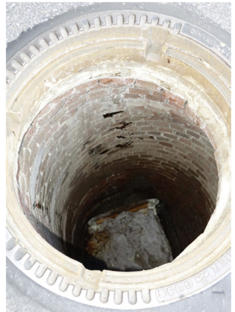
In den Mauerwerksfugen der 110 Jahre alten Schächte fehlt teilweise der Mörtel, und ab einer Tiefe von etwa 3 m tritt Grundwasser ein.
